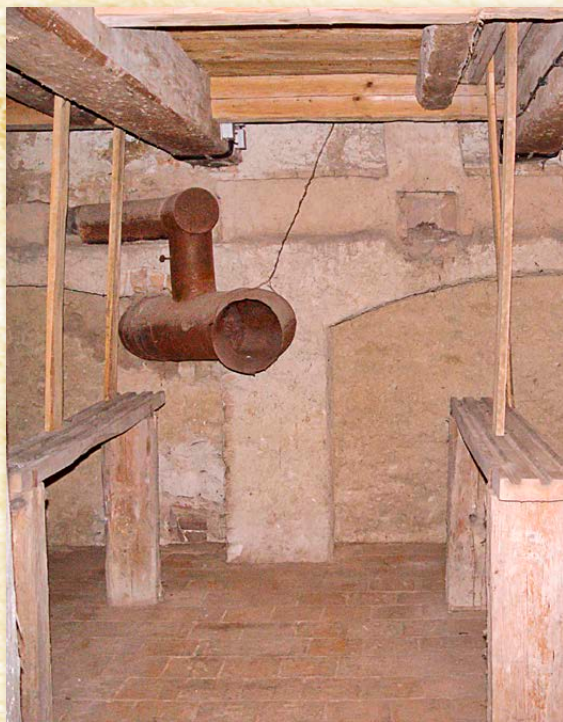
Vyústění topného systému v podjevišti
